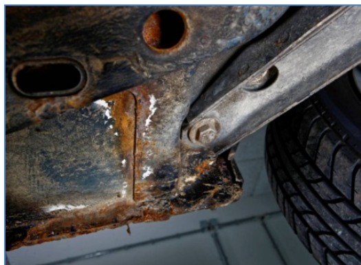
Pilt 3: Pilukorrosioon kahe paneeli ühenduskohal.
